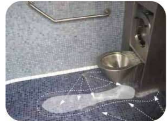
3.- Se limpia y desinfecta el suelo con agua y jabón a presión desde las toberas mas cercanas al inodoro
